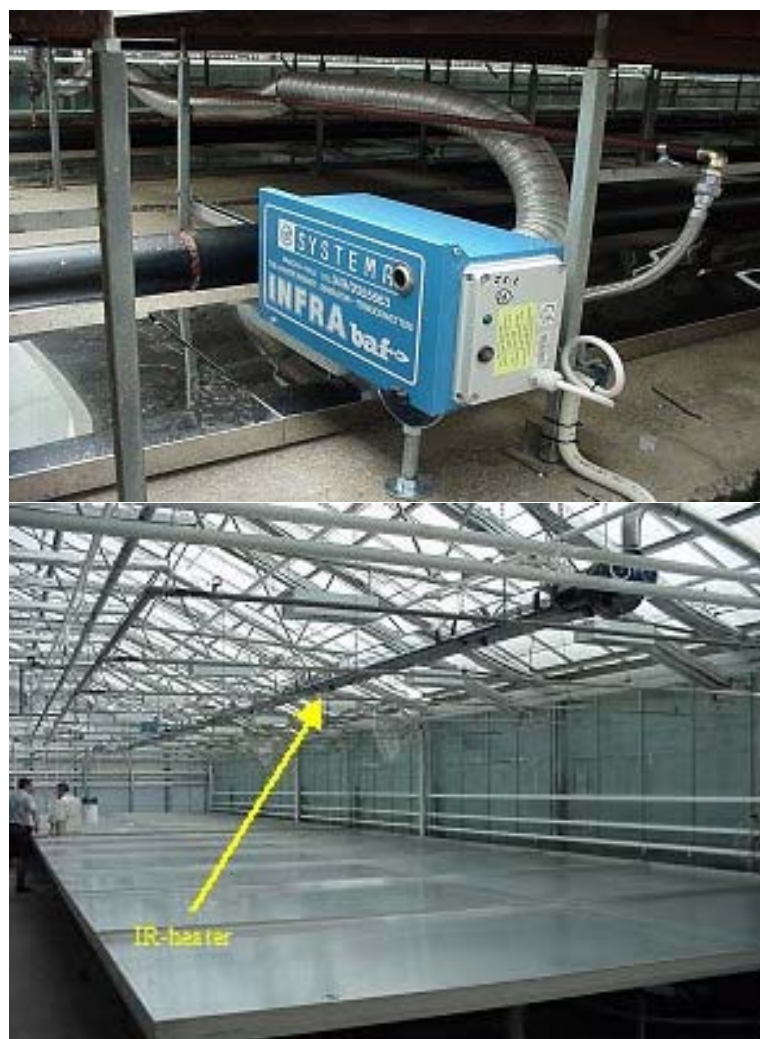
Figur 1.2: Översta bilden visar gasdriven IR-strålare (brännare och strålningsrör) under produktionsborden, och den undre bilden visar strålningsrören över produktionsborden.
