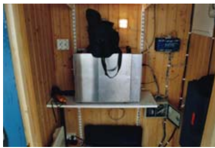
Bränslecell i teknikutrymmet
