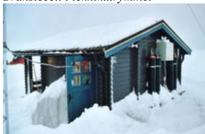
Teknikrum i separat utrymme.
