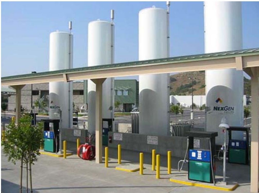
Figur 8: Världens största LCNG-tankstation i Kalifornien i USA. Byggt av Chart-Nexgen.
