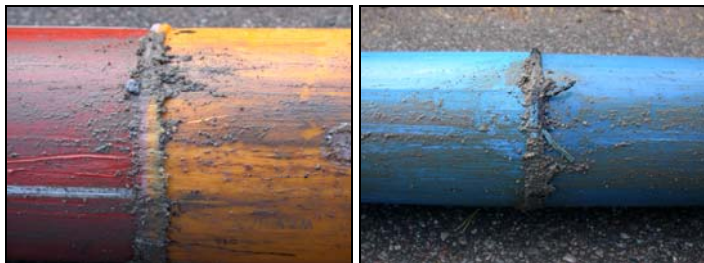
Figur 2. Skrapskador på rör och svetsvulster efter släpning på asfalterad gata (Nilsson & Thörnblom 2005).
