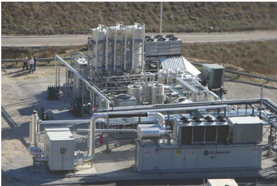
Figur 7: Prometheus Energys anläggning vid Bowerman Landfill.
