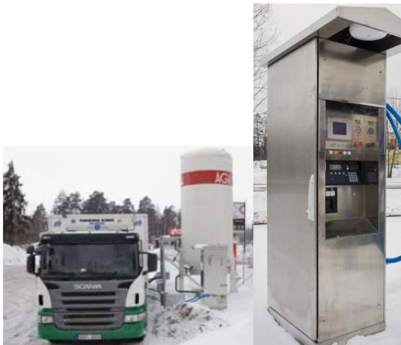
Figur 14: Tankställe för flytande koldioxid, AGA.
