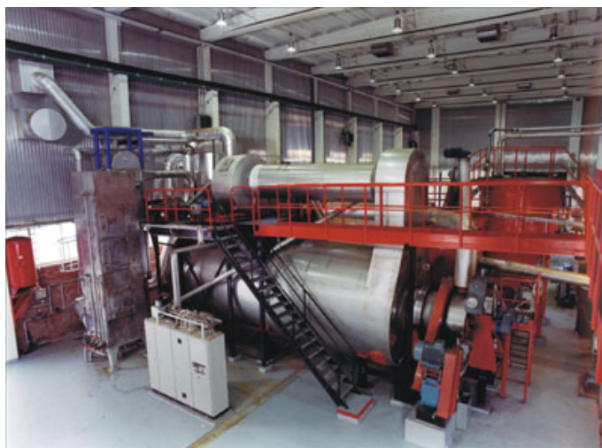
Figur 16. Torkning och pelletering av slam efter mekanisk avvattning 41 .
