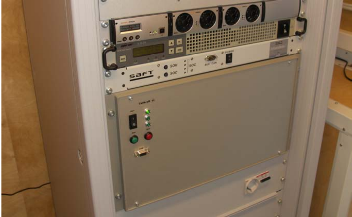
Bild: Bränslecell S-2000 i kraftstativ. Ovanför bränslecell syns litiumjonbatteri, växelriktare och likriktare.
