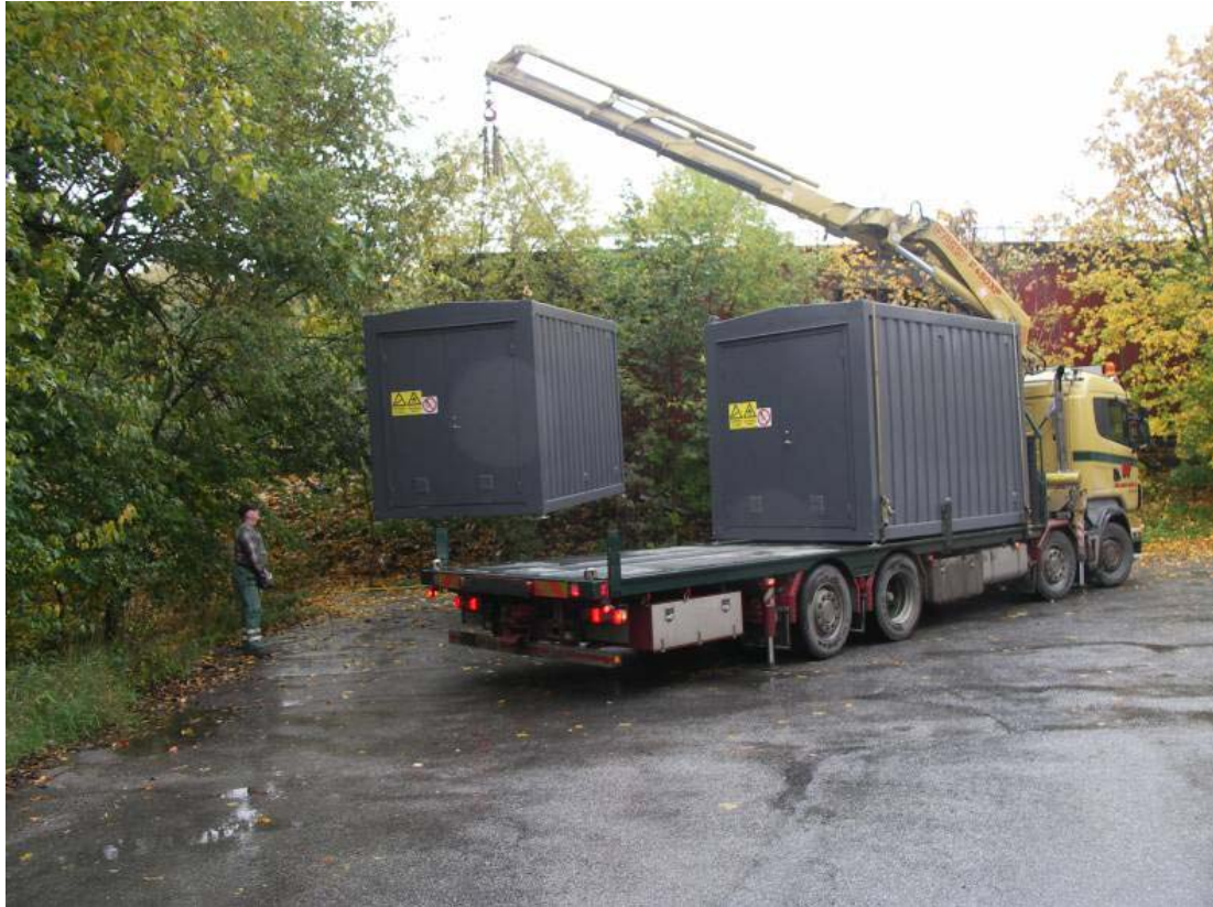
Bild: Leverans av container av telekomtyp för projekt
