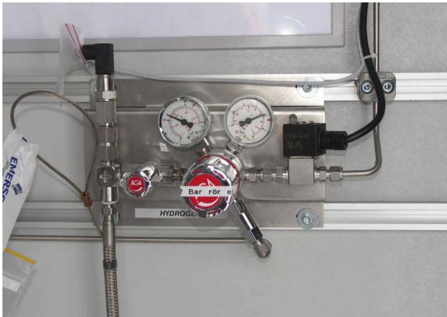
Bild: Cellkraft/AGA gaspanel. Till vänster tas gas in från gaslager. På ledning till bränslecell, till höger på panelen, sitter den säkerhetsventil som styrs av vätgasdetektorn.
