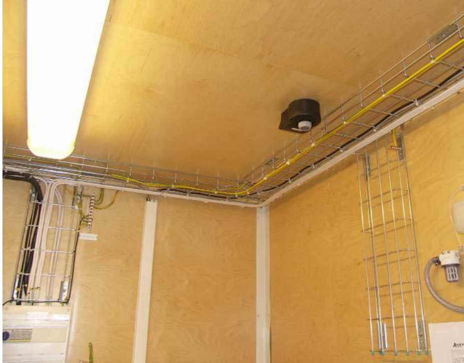
Bild: Teknikutrymme med vätgasdetektor i tak.
