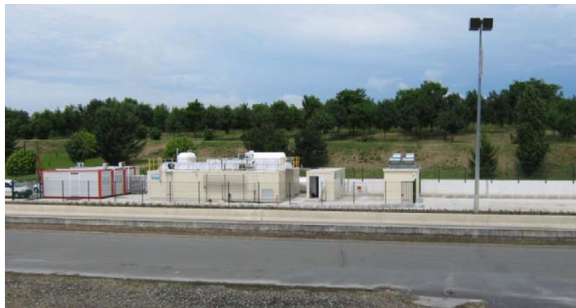
Figur 4.21 Anläggning från Cirmac för uppgradering av deponigas på en deponi i Frankrike. 41
