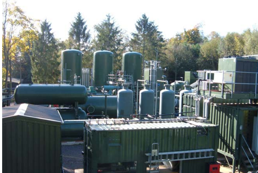
Figur 4.20 Uppgraderingsanläggning för deponigas på Albury Landfill. 39
