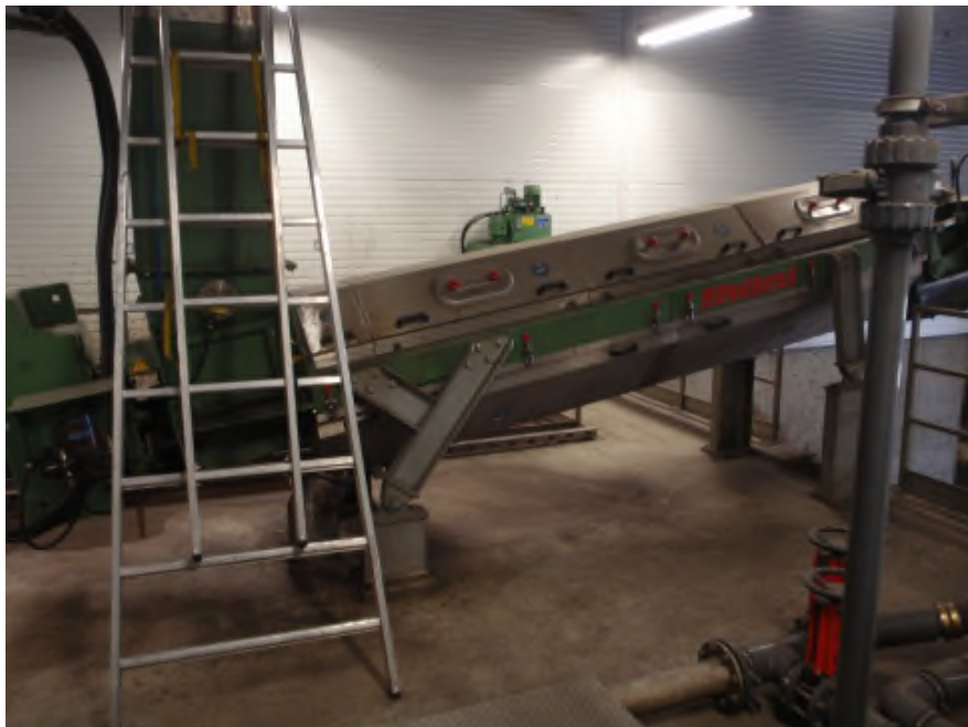
Figur 6.2. Skruvpress direkt efter rötrestlager
