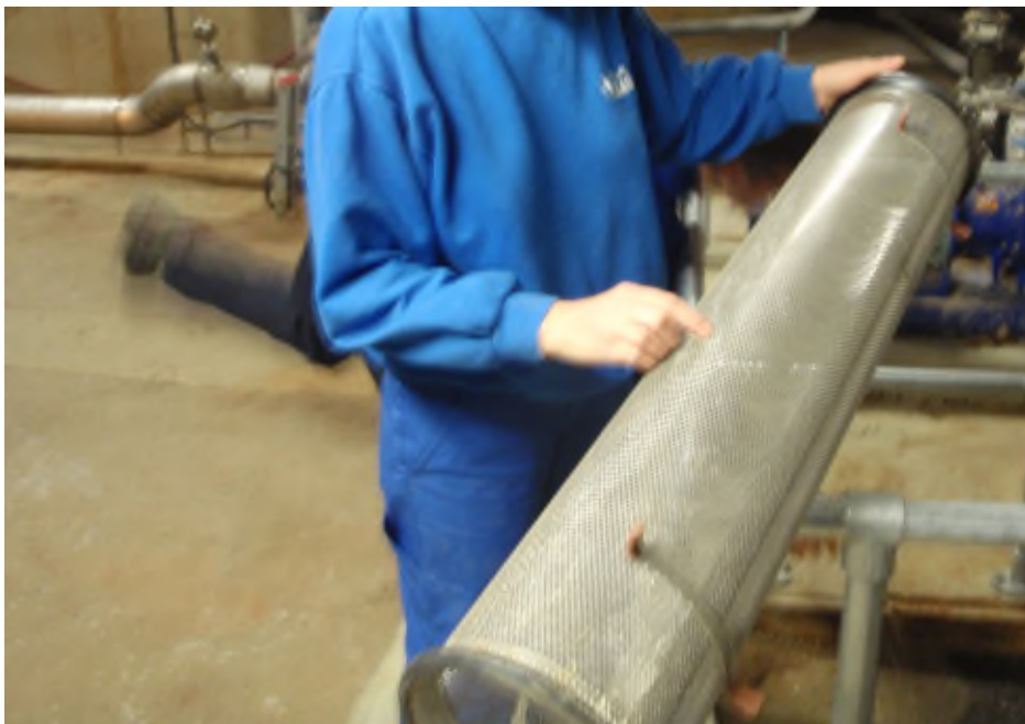
Figur 6.11. Förfilter ammoniakstripping – insats 3500 mikron
