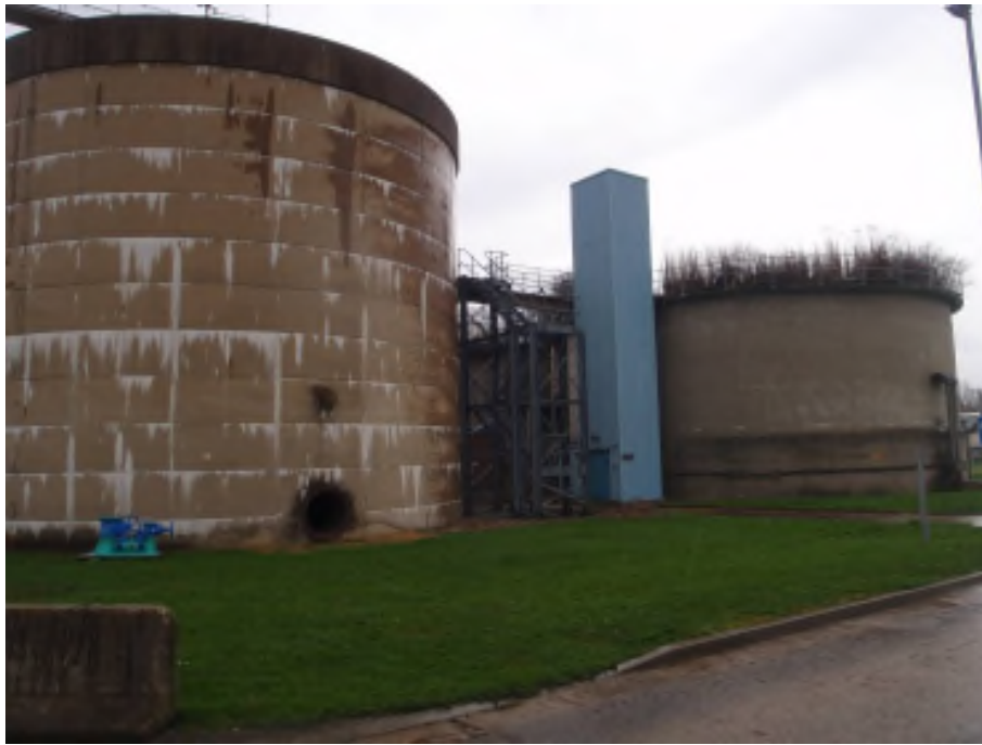
Figur 6.19. Slough avloppsreningsverk, rötkammare
