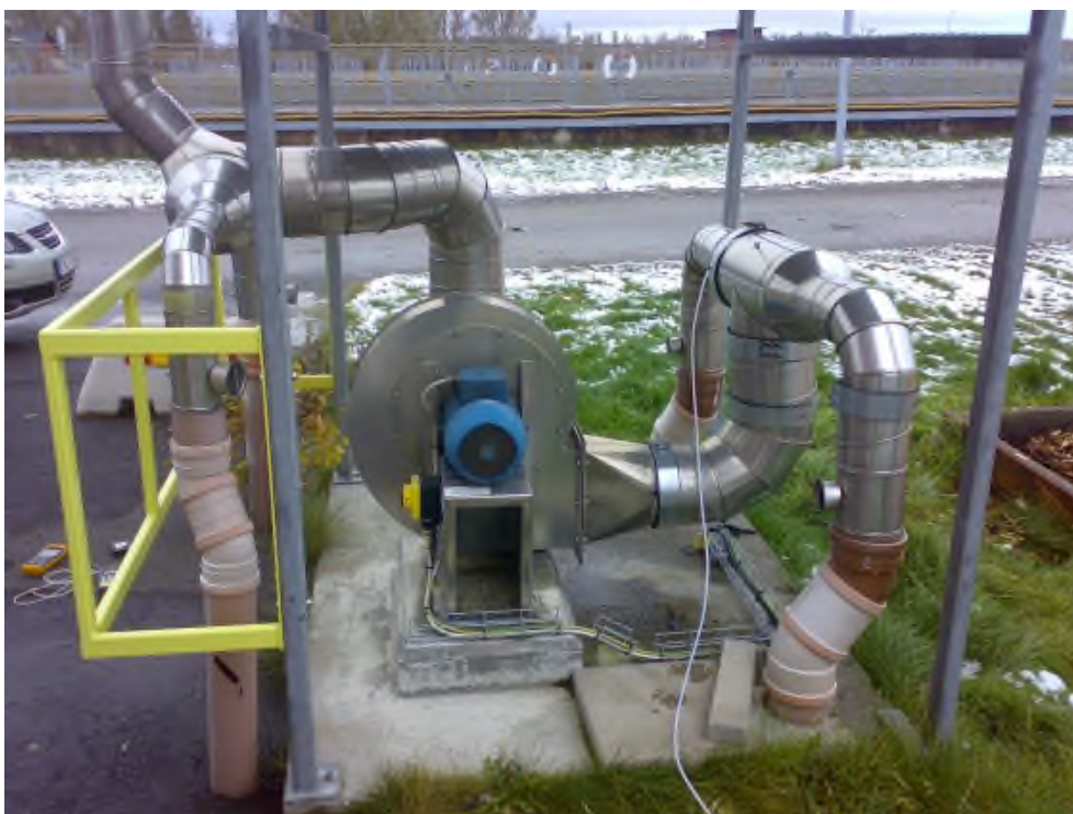
Figur 8. Ventilationsfläkt med 3 st delflöden på sugsidan och 2 st delflöden på trycksidan.
