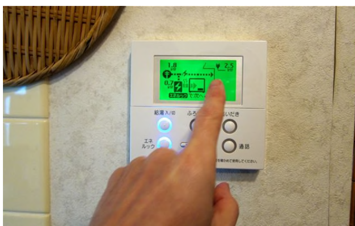
Figur 8.1b. Foto av en sk smart house control-enhet som optimerar mCHP systemet efter husägarens förbrukningsprofil.
