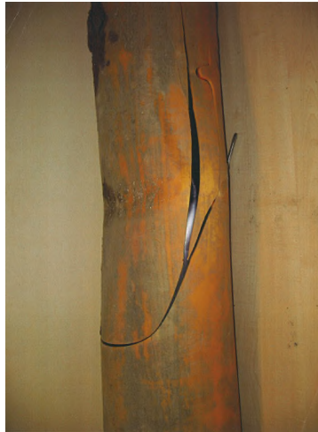
Figur 11. Bild på det spruckna röret.
