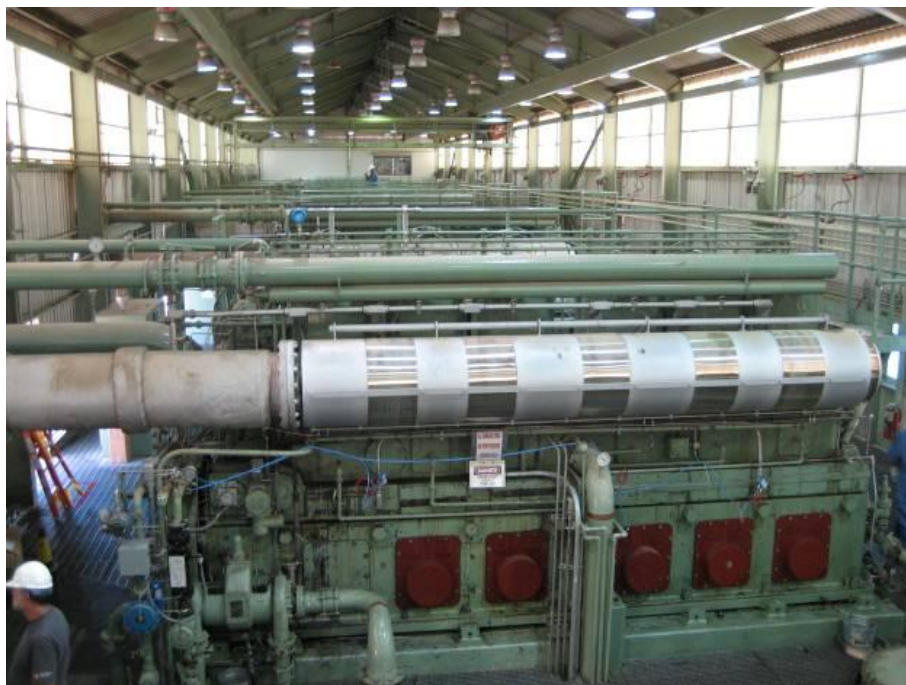
Figur 1. En maskinhall med många industriella gasmotorer som används för att pumpa gas över gasledningar i USA.
