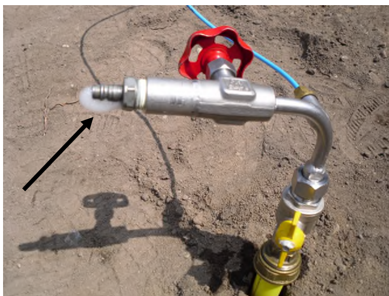
Figur 15. På bilden ses kopplingen som användes med den gamla metoden. Notera att det skummande såpvattnet tydligt påvisade läckage i kopplingen på grund av att nålventilen (rött vred) inte var helt åtdragen.
