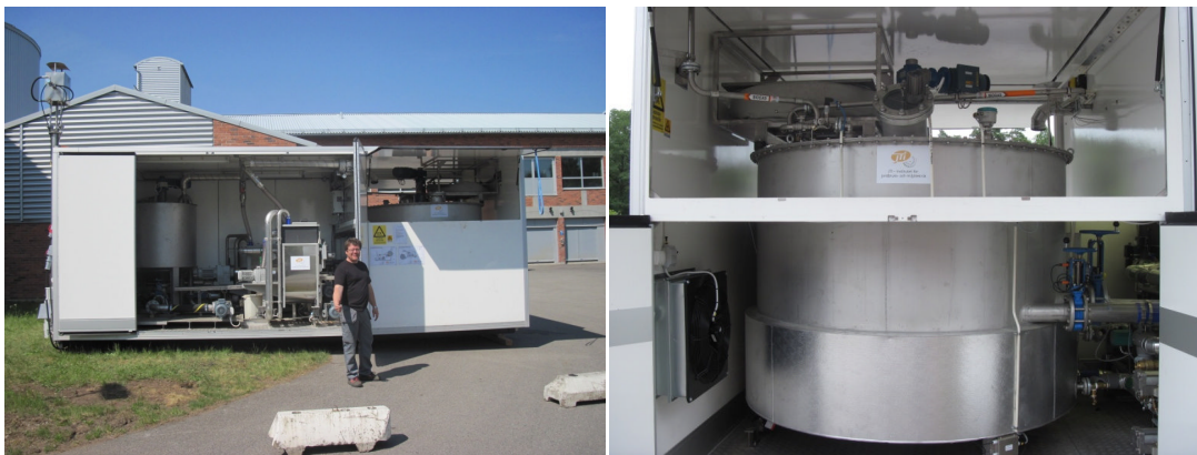
Figur 4. JTI:s mobila pilotanläggning som användes i försöken. Översiktsbild av pilotanläggningen och dess vinterisolerade överbyggnad till vänster och detaljbild på själva pilotrötkammaren till höger.
